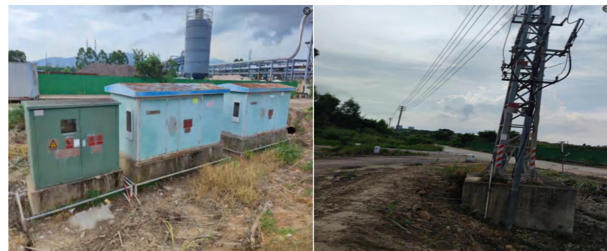
中兴六路沿线现状电力设施
