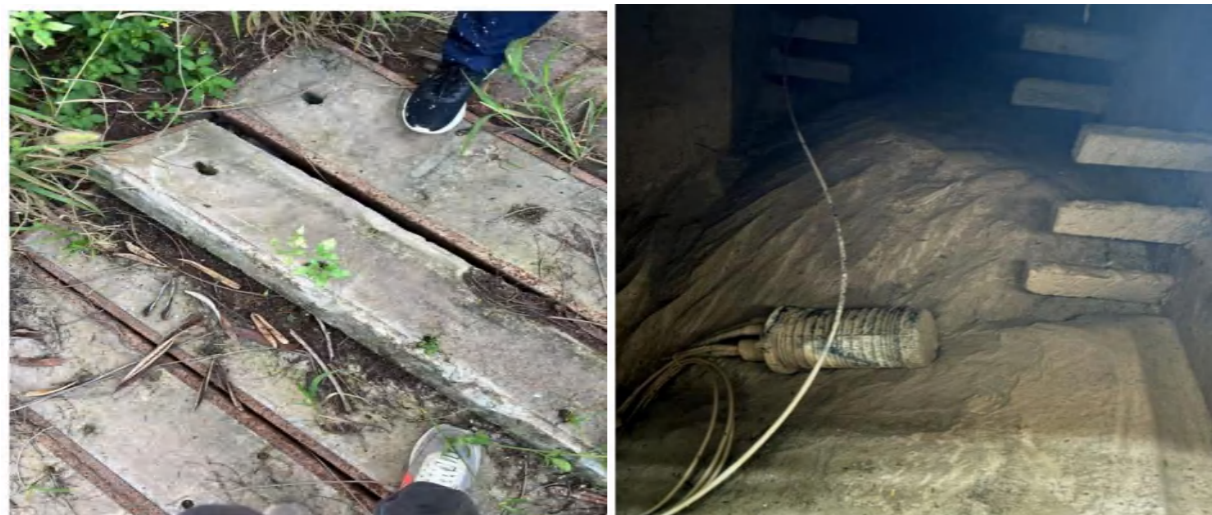
临站二路（进站东路-进港路）现状电力设施
