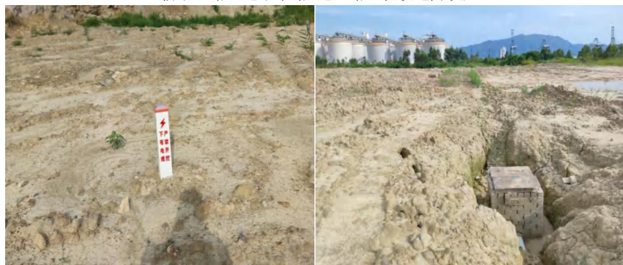
临站二路（进港路-进站南路）地埋 10kv 高压电缆
