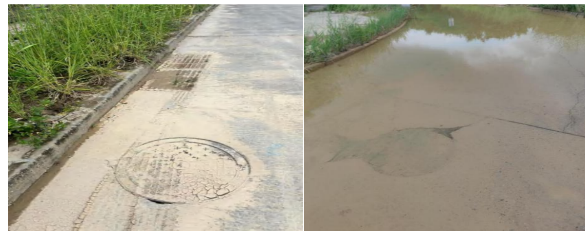
现状雨水设施
