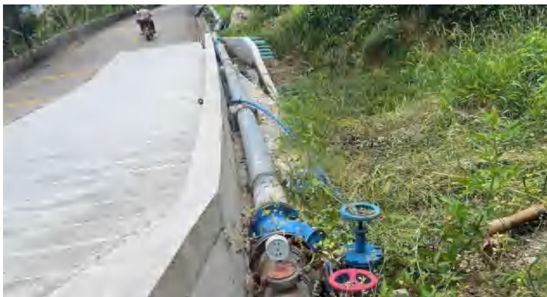
图 3.1-8 五指山主入口至茶园路段给水管废弃现状
